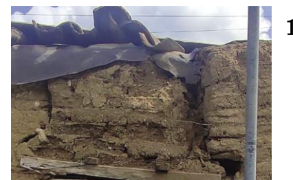
ρωγμές στην πίσω όψη
